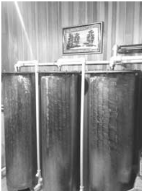
Фильтры «Геракл» в системе водоочистки в частном доме. Фото Аллы Герман
